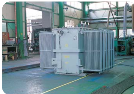
▶ 고압시험용 TR (High Voltage Test TR upto 6600V)
